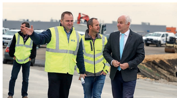
Pántya Józseffel, a NIF Zrt. útfejlesztési igazgatójával, az M44 békéscsabai végcsomópontjának építésén
